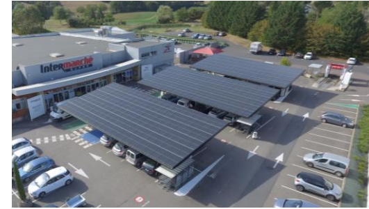
Localisation : Martel (46) Puissance : 160 kWc Terrain : enrobé
