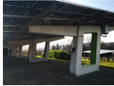
Localisation : Capdenac (12) Puissance : 140 kWc Terrain : 0-20c compacté
